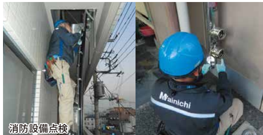
消防設備点検
